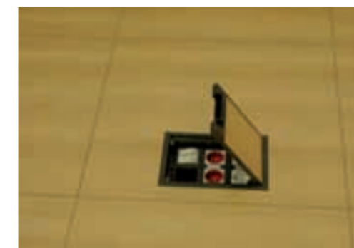
Detalle tapa de registro en suelo técnico.
