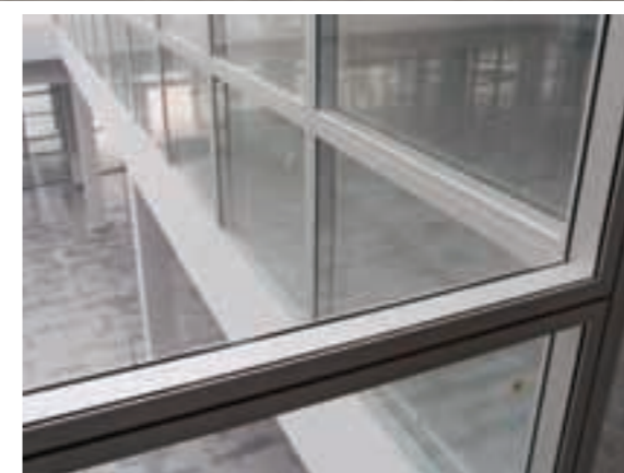
Entrecalle de perfilera cubierta por tapeta y lambeta en cara exterior e interior respectivamente.
